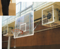
設置された空調設備
